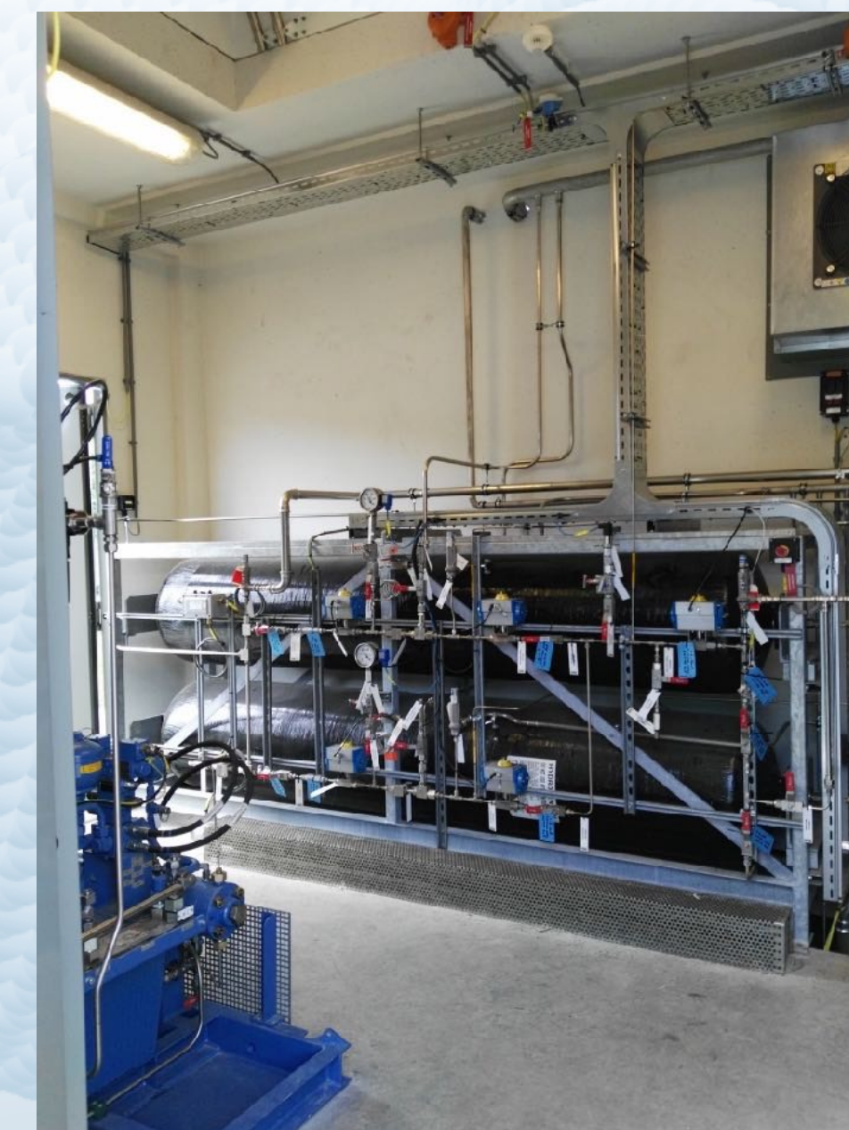
Duże bufory po 700 barów w budynku technicznym stacji, gotowe do dostarczenia.
